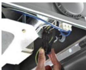
سوکت و پلاگ برای قطع و وصل کردن برق در زمان سرویس و نگهداری
